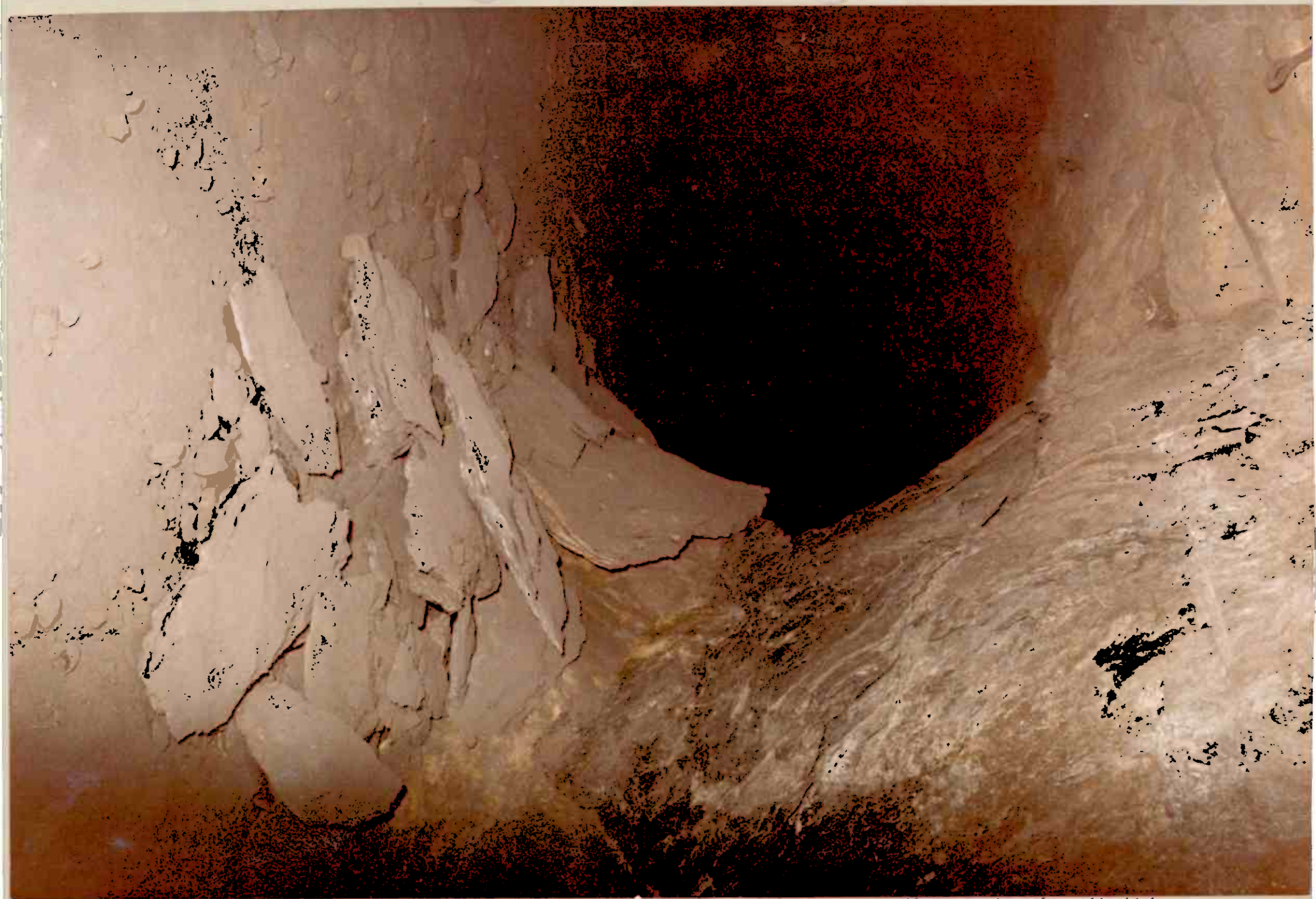
Ned ← NIVA 6 - VEST. AVSKALLING - bergslagg i begynelse av sydlig feltort. Utsikt OPP → mot vest fra tvertslag ca. fra X+5 og Y+0313 FOTO: M. H. MOTVS ETTER RAS ca. den 26. 04. 1987 Tverrfjellet 07. 05. 1987.
