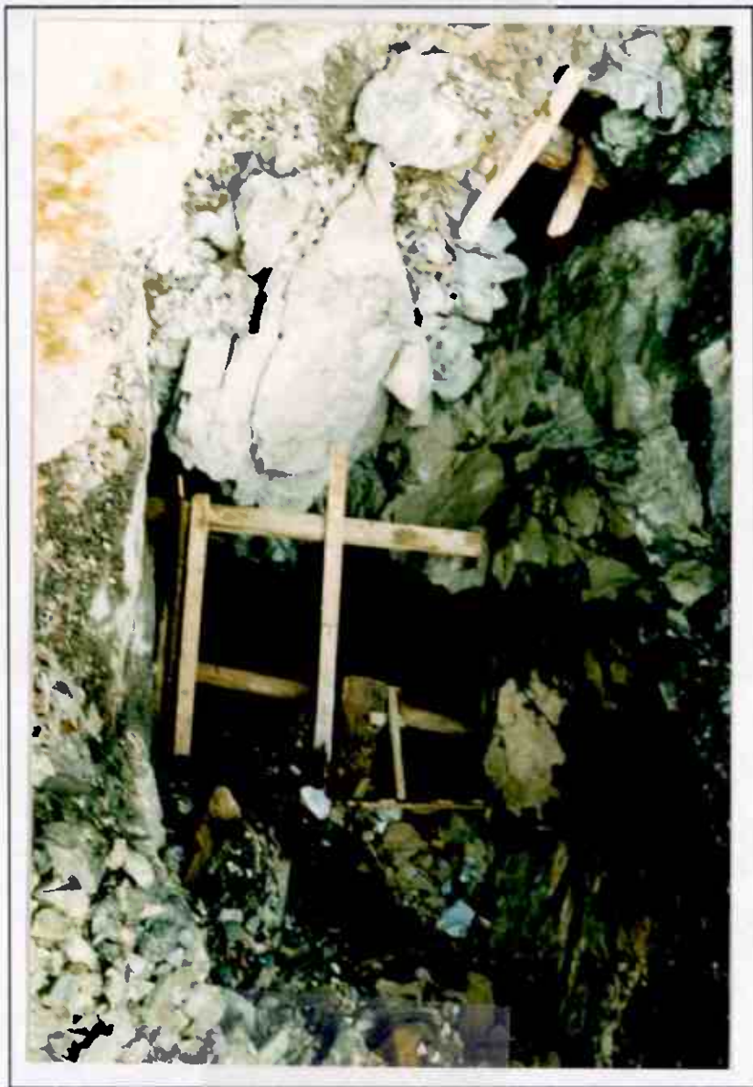
Restene av raset i Haugesundsgangen sett ovenfra
