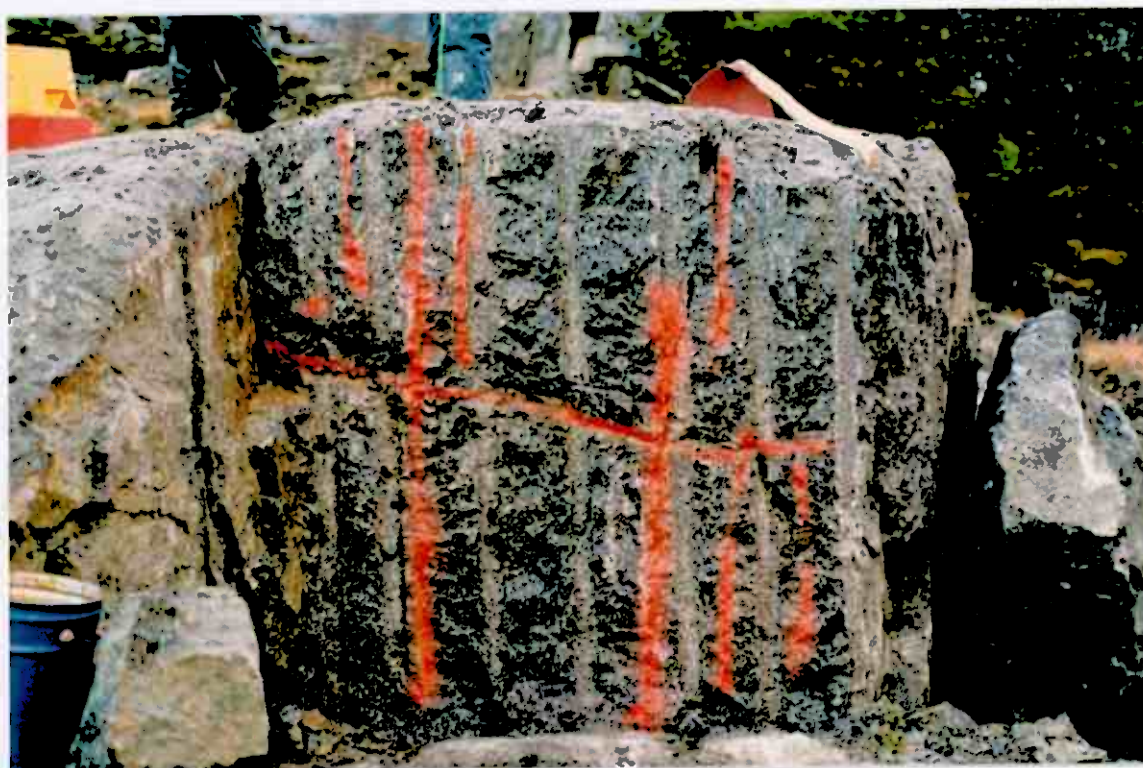
Fig. 8: Sprekker avdekket ved første oppdeling. Merk forflytningen av enkelte sprekker.
