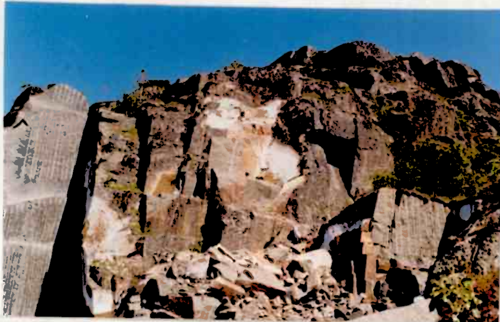
Fig. 3-10. Bildet viser oppsprekking rett øst for bruddet.
